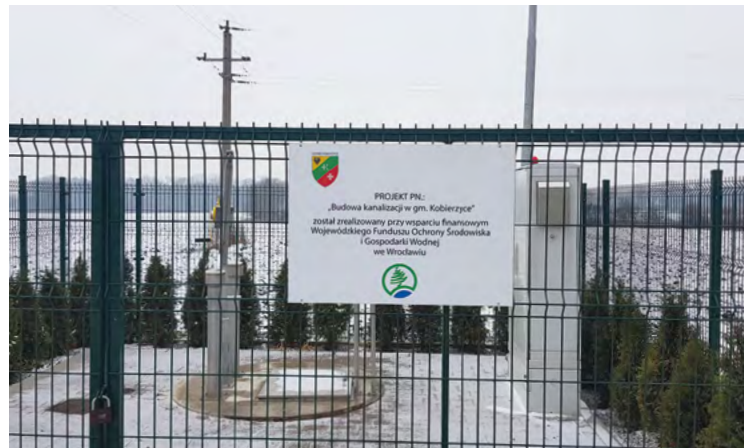
Stacja pomp w Cieszycach
